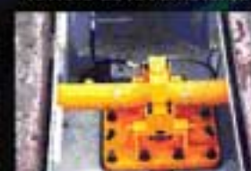
▲ Conversión hidráulica de la maquinaria de las esclusas
